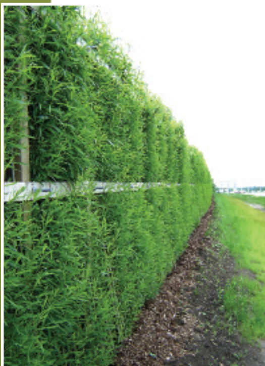
Mur végétalisé antibruit installé le long d'une autoroute (photo M. Labrecque)
